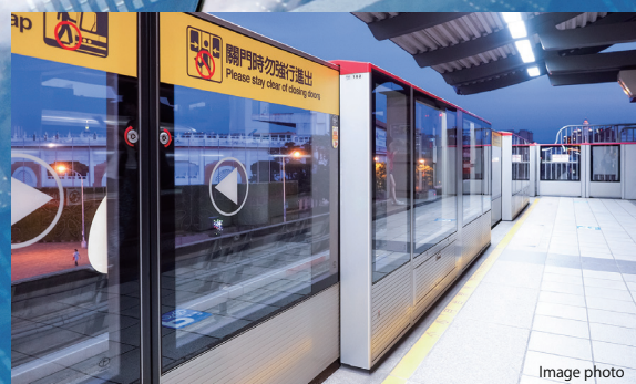
ホームドア Platform screen doors
